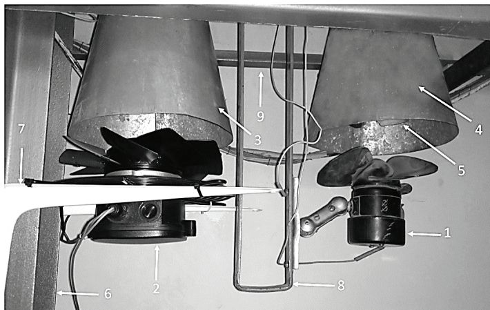
Рис. 3.6. Общий вид магистралей горячего и холодного воздуха
