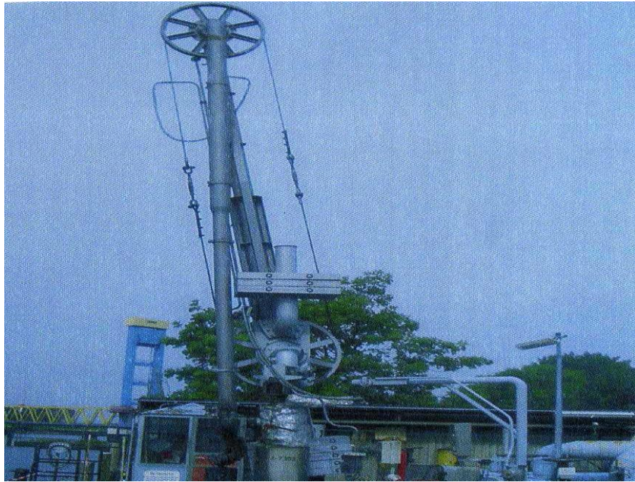
Рис. 2.7. Специальные устройства (стендеры) для слива (налива) на причалах
