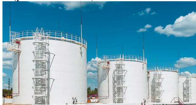
Рис. 5.3.3. Резервуары вертикальные стальные (РВС) ТЗК
